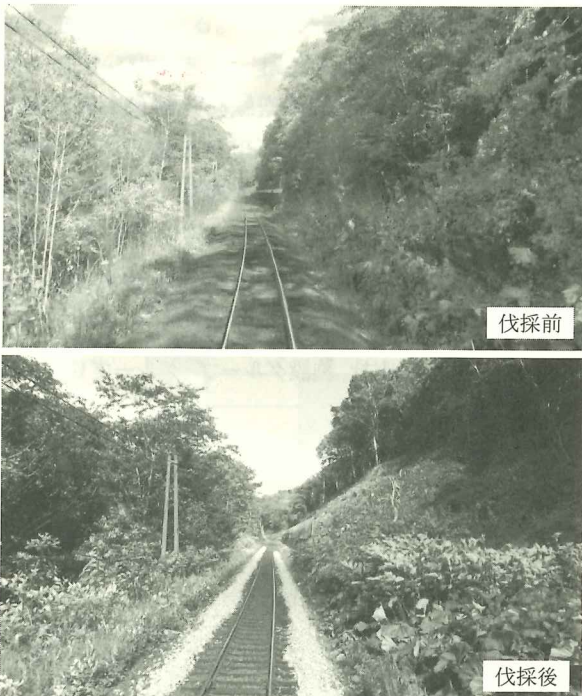
写真-2 沿線木伐採例(石北線60k000m付近)
